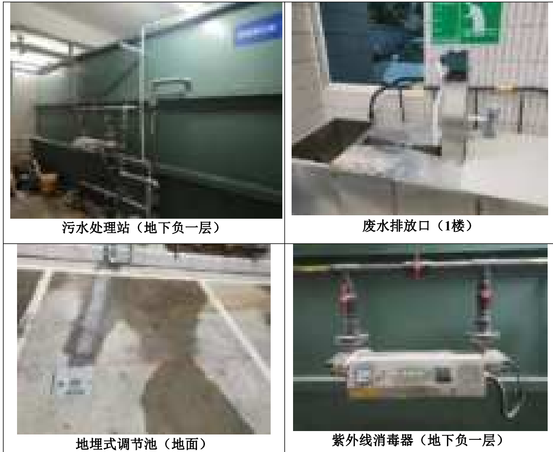
图 3.1-2 项目污水处理设施
